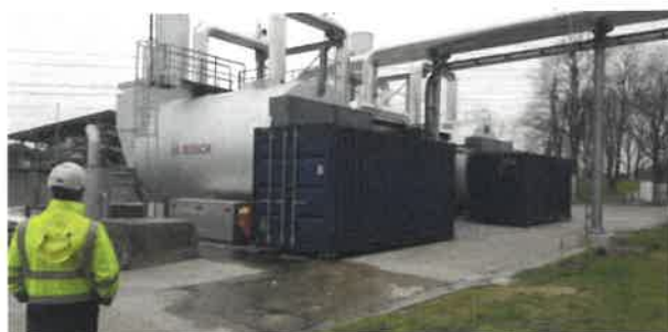
Les 2 chaudières mixtes en extérieur
